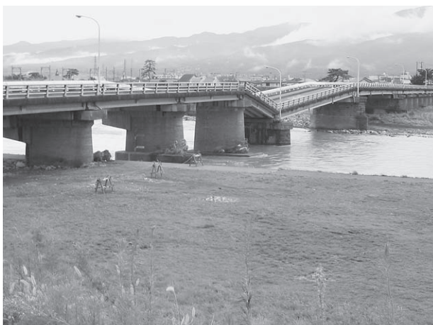
9月7日、台風9号で松田町～開成町を結ぶ十文字橋が落下
